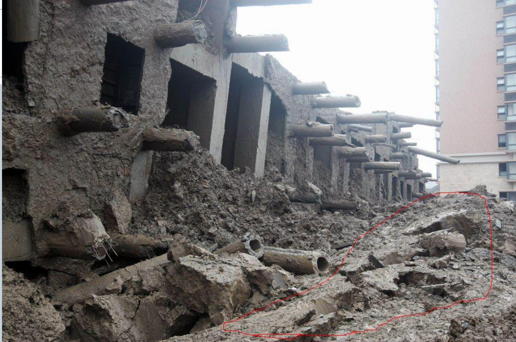
图13 红线内土的破坏是桩被拔出造成的
