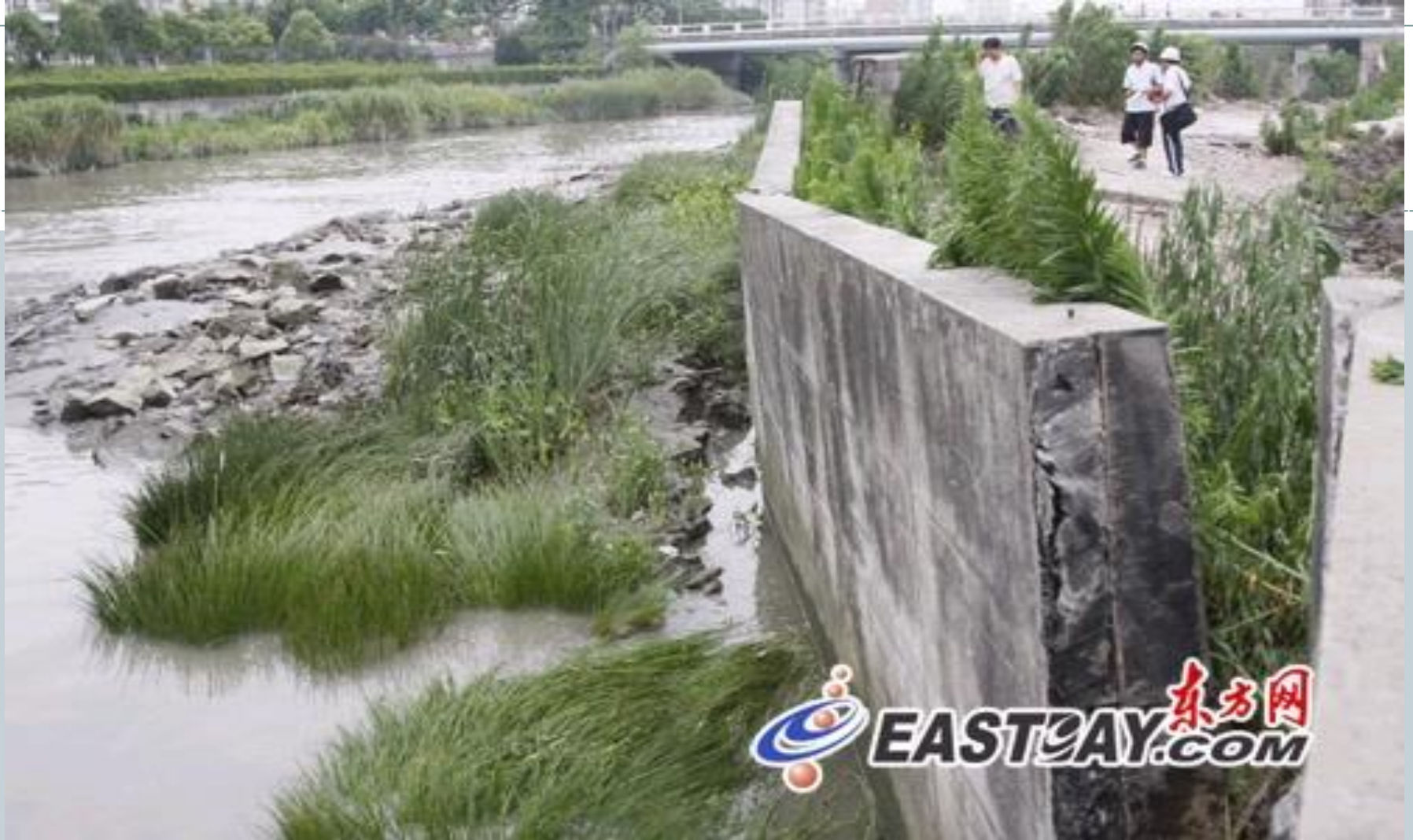
图6 工地旁防汛墙破坏图
