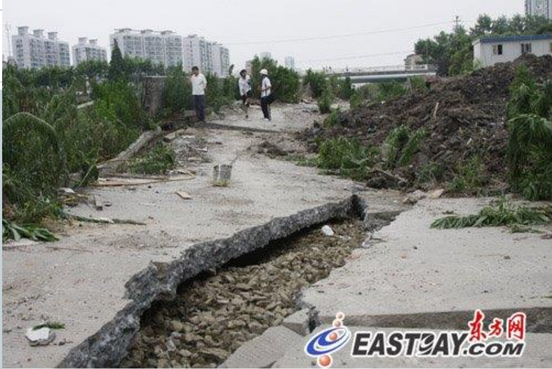
图7 工地内防汛墙旁地面的大裂缝
