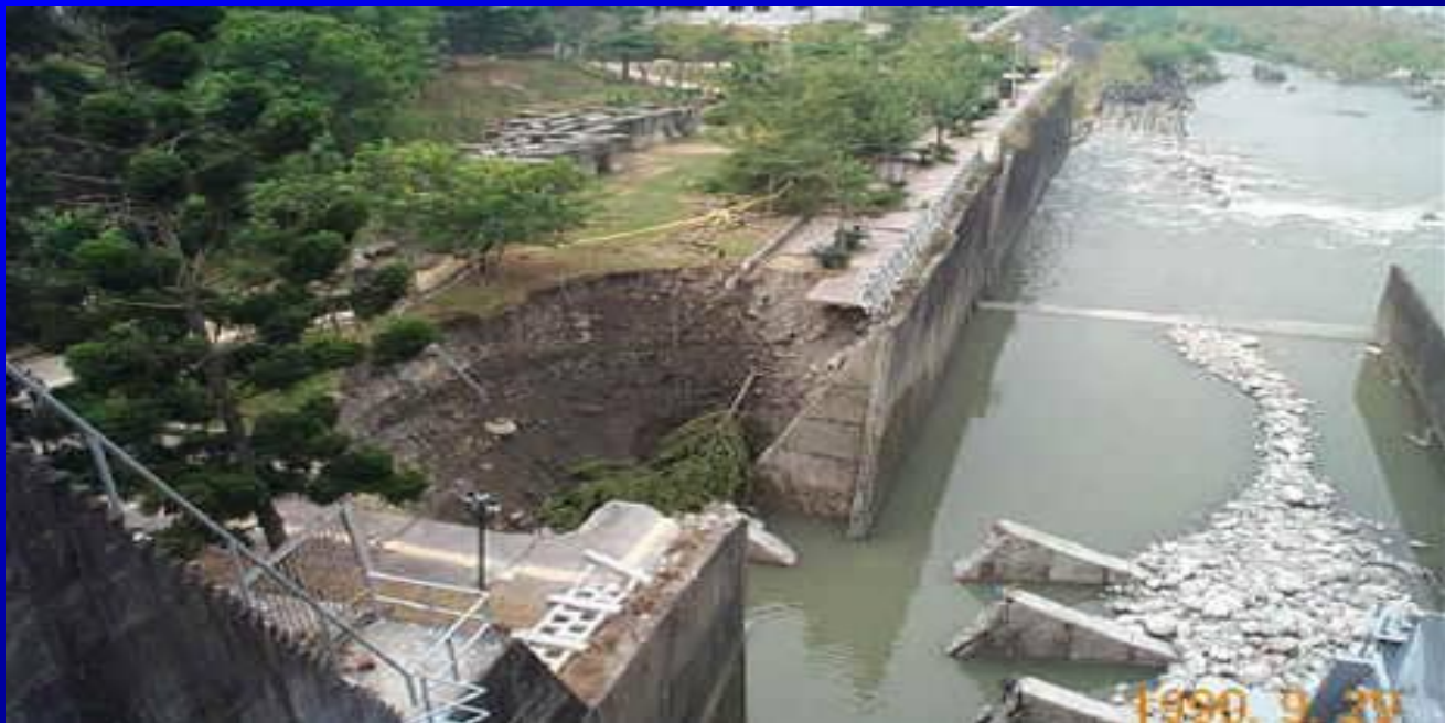
垮塌的重力式挡墙
