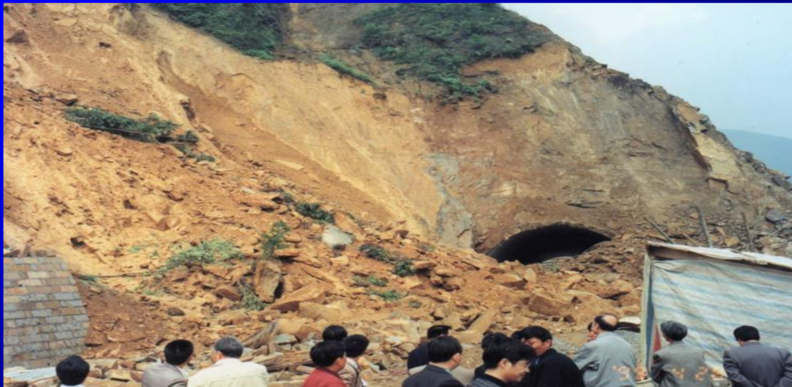
垮塌的护坡挡墙
