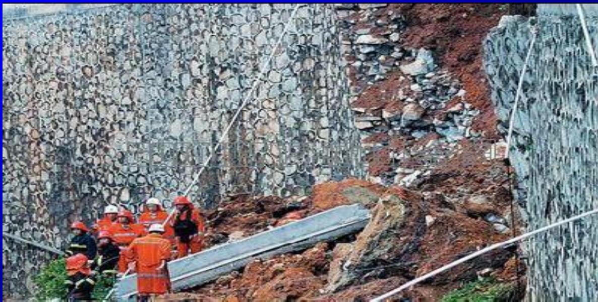
垮塌的护坡挡墙
